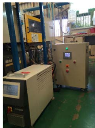
แผนภาพที่ 10 ติดตั้งระบบหล่อเย็นแม่ (RHCM)
